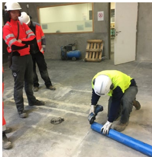
Réalisation d'un chanfrein par un des nouveaux fontainiers à l'aide d'une meuleuse équipée d'un disque adapté.
