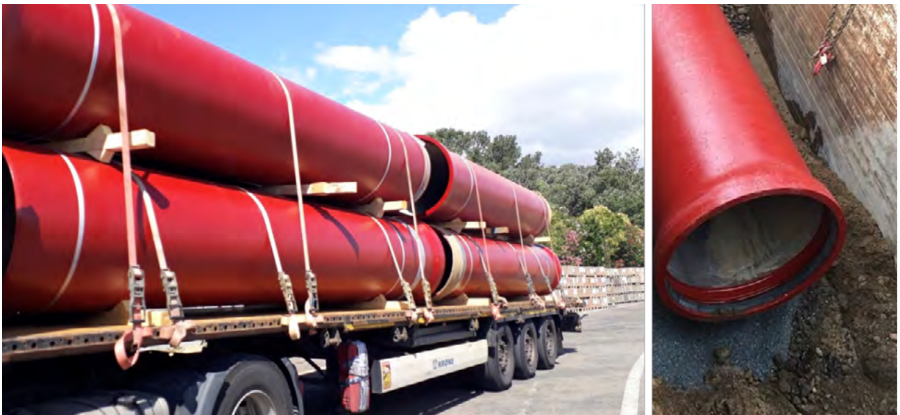
Départ des tuyaux en fonte ductile depuis la plateforme logistique de Arles et opération de pose sur site.
